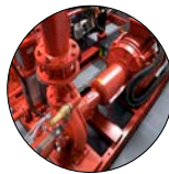
Detalle de bomba eléctrica.
