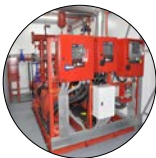
Equipo Contra Incendios
