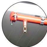
Detalle de rociador.
